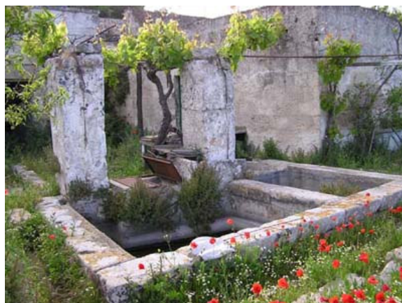
Fig. 10 – Stato attuale di abbandono delle antiche cisterne.
