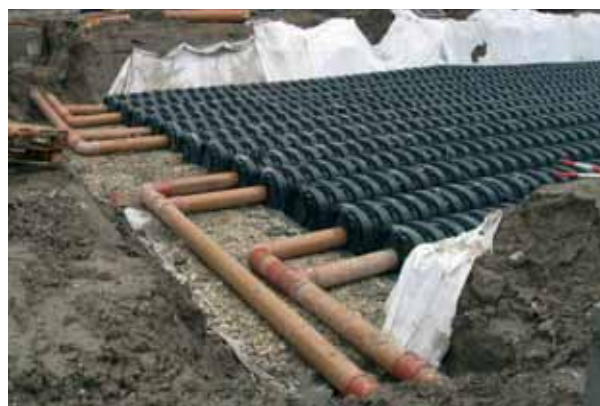
Il cantiere in piazza XX Settembre. Dall’alto, posa del tessuto-non tessuto, del bacino di accumulo realizzato con elementi non fessurati, dei tubi di collegamento con le caditoie.
