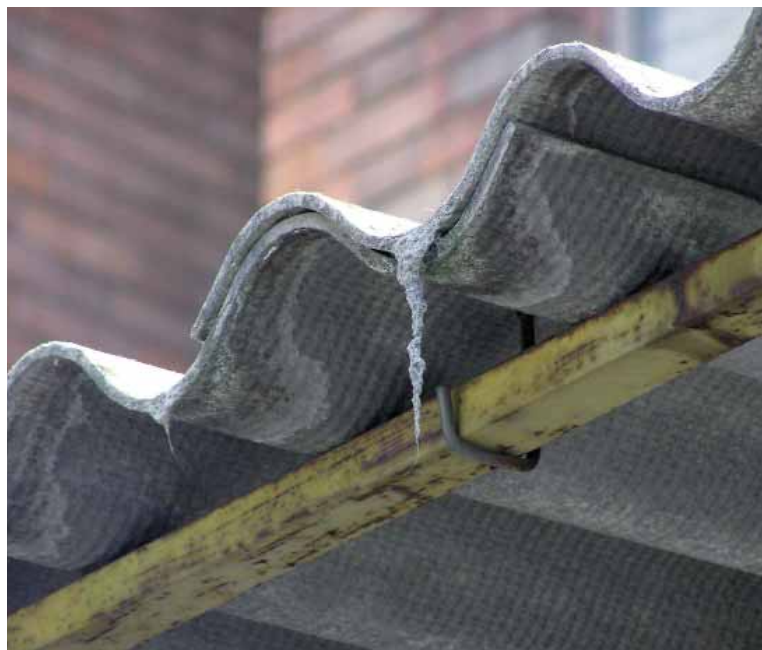
Sopra, coperture in amianto in fase di sfaldamento generano "ragnatele" di fibrille. In basso, alcuni residui abbandonati.
